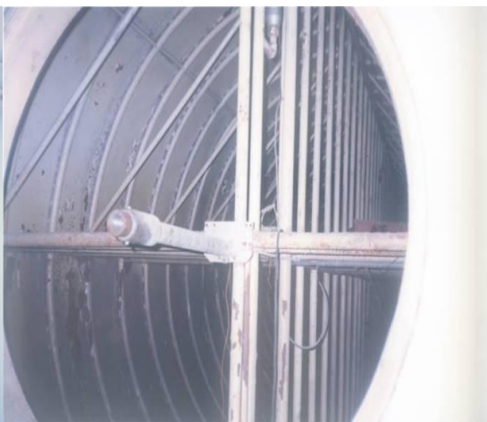
大型减压库库体
